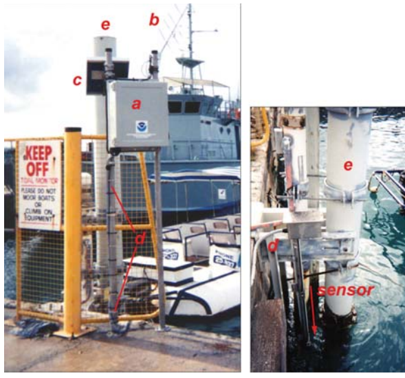
Station marégraphique de Rarotonga, port d'Avarua, dans les Îles Cook. L'appareillage électronique placé dans un coffret en fibre de verre (a), l'antenne (b), le panneau solaire (c) ont été installés sur un môle. Les câbles qui relient le capteur, situé à un mètre cinquante sous le niveau de basse mer, à la plate-forme de collecte des données contenant l'équipement électronique, sont enfermés dans une gaine (d) fixée à l'extérieur du tube (e) abritant le capteur
